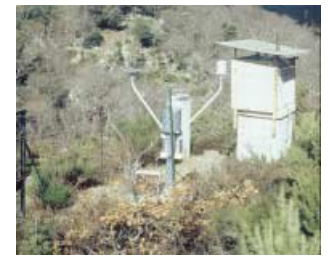
Photo n°38 : Station météorologique de la RN de la Forêt de la Massane. ©V. FIERS.
